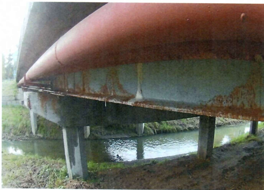
Fot. 4. Korozja jednego z dźwigarów głównych
