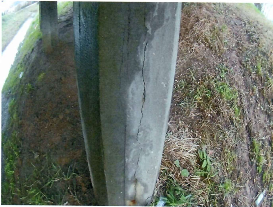
Fot. 2. Pęknięcie betonu w filarze
