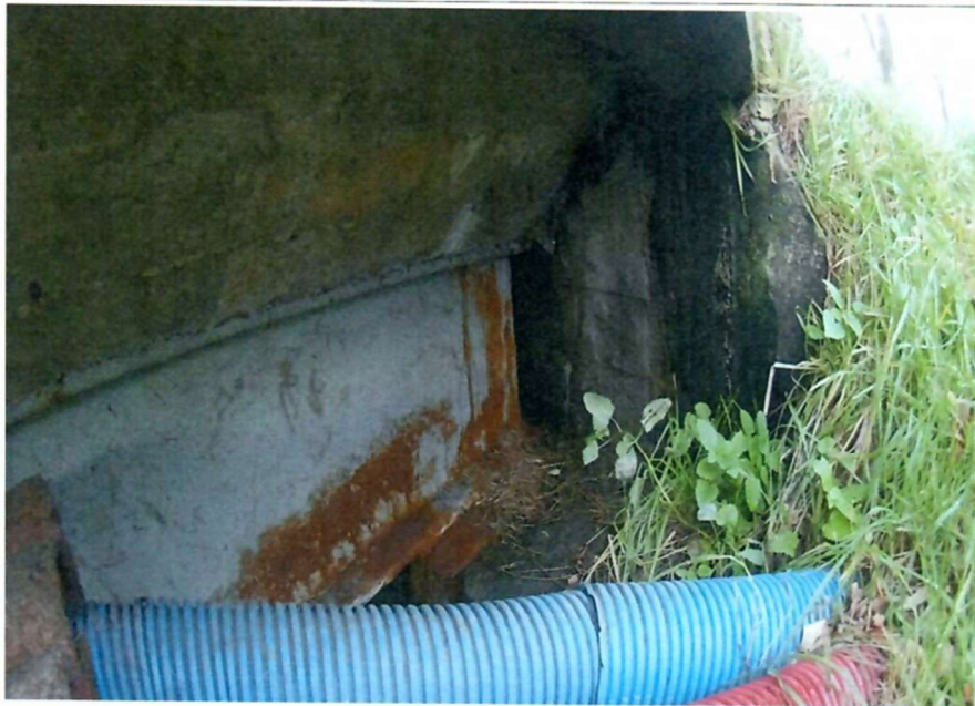
Fot. 3. Zaawansowana korozja elementu łożyska
