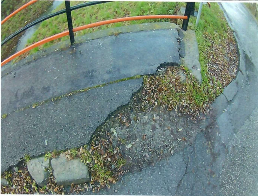
Fot. 1. Rozległe ubytki w nawierzchni chodnika
