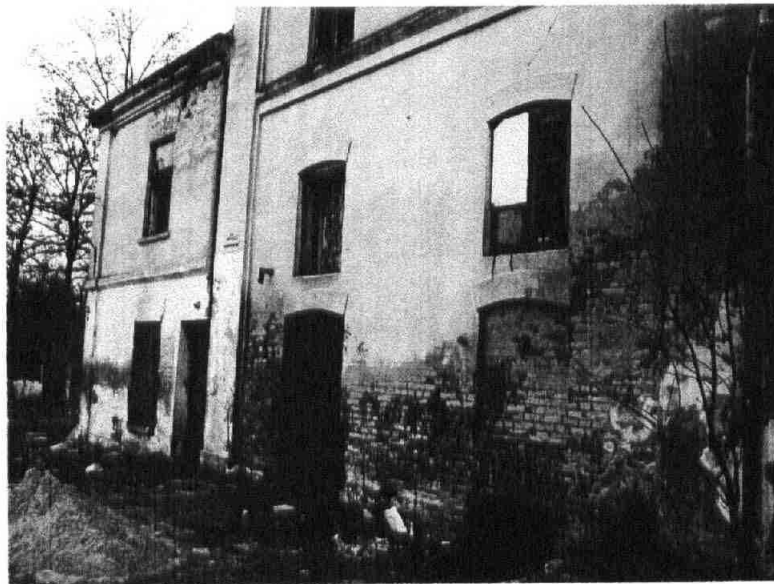
Fot. 5 Budynek dawnego browaru. Widok elewacji segmentu D i E od strony wewnętrznego dziedzińca. Zniszczone korozyjne tynki zewnętrzne w dolnej części. Stolarka okienna w stanie szczątkowym.
