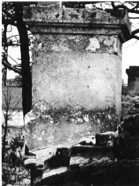
Fot. 11 Uszkodzony komin na segmencie C stwarzający zagrożenie zawaleniem.
