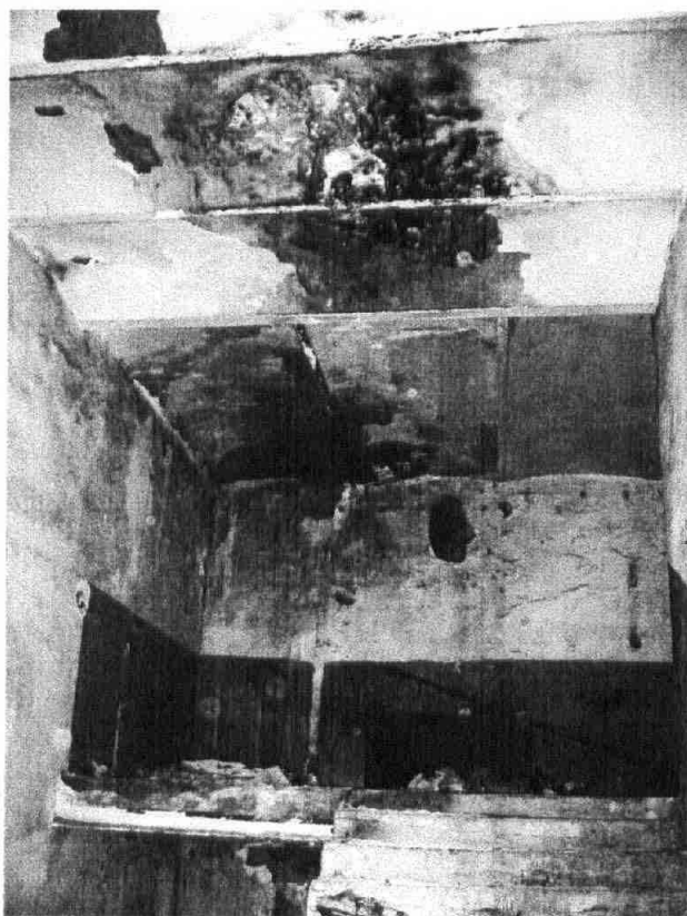
Fot. 14 Zniszczenia i uszkodzenia stropów odcinkowych klatki schodowej w segmencie D. Nie występuje zagrożenie bezpieczeństwa konstrukcyjnego. Klatka schodowa pozbawiona balustrad stwarza niebezpieczeństwo poruszania się.
