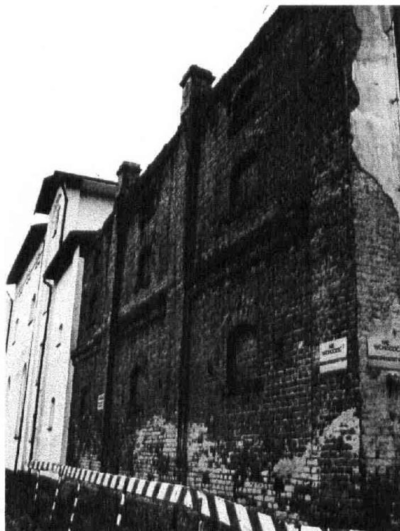
Fot. 2 Budynek dawnego browaru. Widok elewacji segmentu C od strony ulicy Polnej. Elewacja bez wypraw tynkarskich. Zniszczenia korozyjne ścian w dolnej części związane z zawilgoceniem murów.
