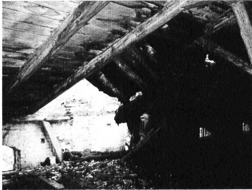
Fot. 8 Drewniana więźba dachowa nad segmentem C znajdująca się w stanie awaryjnym. Zniszczone całkowicie dwie krokwie i zawalona połać dachowa od strony wschodniej.
