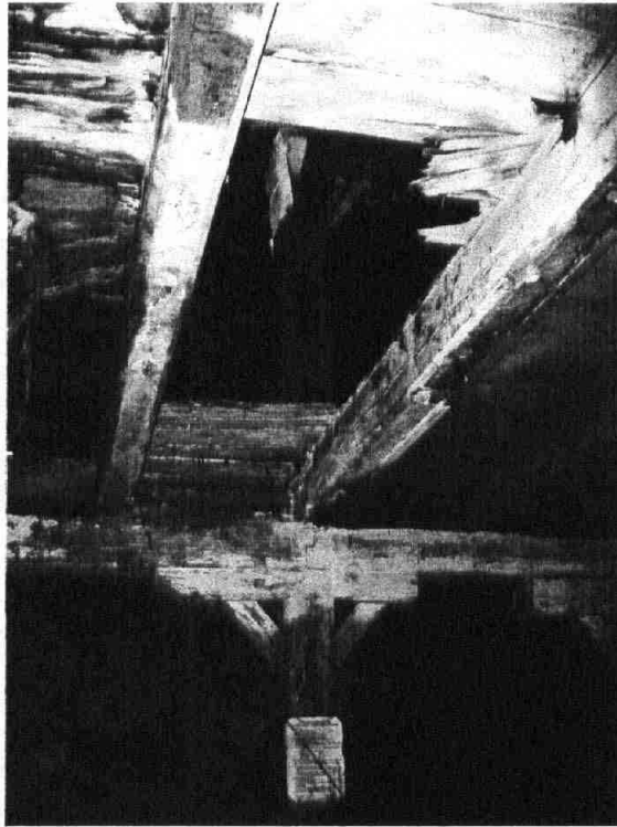
Fot. 10 Drewniana konstrukcja stropowa w segmencie C. Drewniane podciagi oraz belki stropowe nie wykazują stanu zagrożenia konstrukcyjnego. Całkowicie zniszczona konstrukcja drewnianej podłogi uniemożliwia komunikację i stwarza zagrożenie bezpieczeństwa życia i zdrowia.
