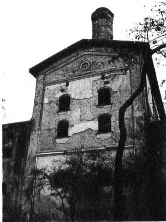
Fot. 4 Budynek dawnego browaru. Widok elewacji segmentu D od strony ulicy Siennieńskiej. Zniszczone korozyjne tynki zewnętrzne odpadające od podłoża. Stolarka okienna w stanie szczątkowym.
