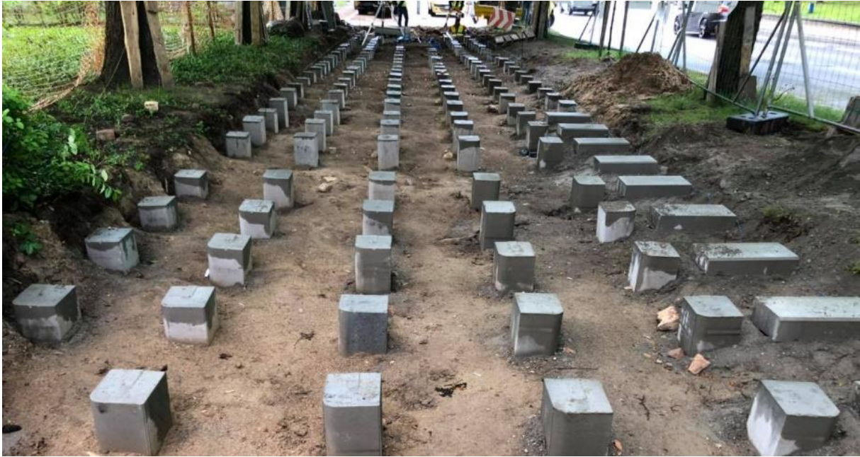
Ryc. 37 Betonowe posadowienie nawierzchni podwieszanej. Źródło: Podwieszana ścieżka rowerowa w Białymstoku ominię korzenie drzew. (whitemad.pl)
