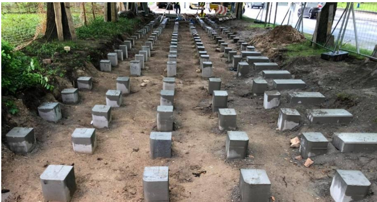
Ryc. 37 Betonowe posadowienie nawierzchni podwieszanej. Źródło: Podwieszana ścieżka rowerowa w Białymstoku ominię korzenie drzew. (whitemad.pl)
