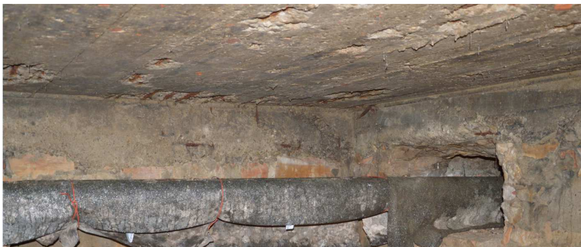
fot. Stan techniczny płyty z widocznymi drobnymi odpryskami
